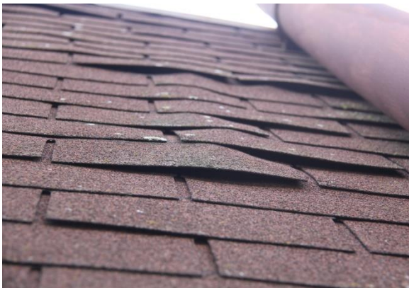
Photo : Plaques de bardeau bitumé soulevées
